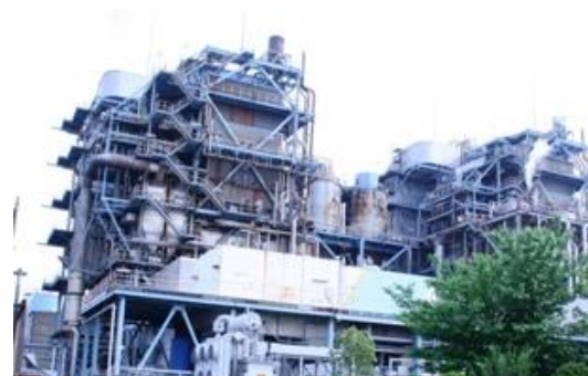
(発電設備・川崎市)
